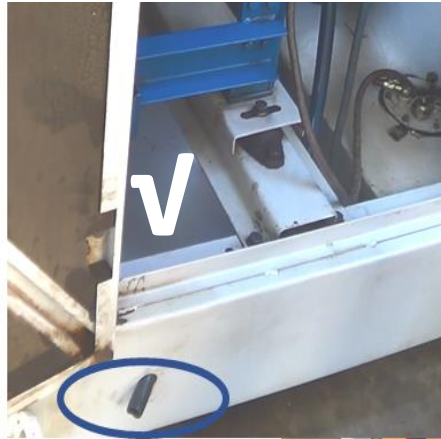
Entlüftungsrohr außerhalb der Schallschutzhaube
